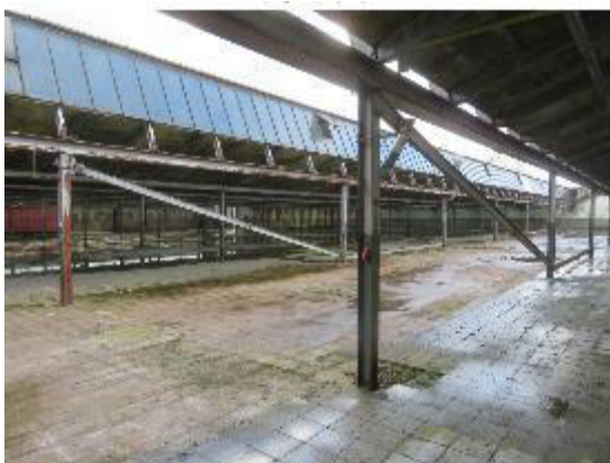
Abb. 4: Innenansicht einer baufälligen Werkshalle mit fehlendem Dach.
