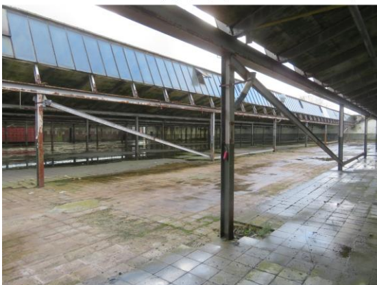
Abb. 4: Innenansicht einer baufälligen Werkshalle mit fehlendem Dach.
