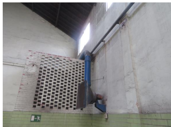
Abb. 27: Schmelzspuren an einem Rohr
