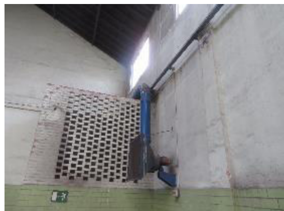
Abb. 27: Schmelzspuren an einem Rohr
