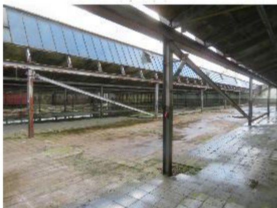
Abb. 4: Innenansicht einer baufälligen Werkshalle mit fehlendem Dach.
