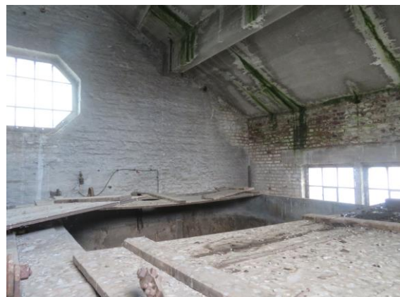
Abb. 21: Dachraum des höheren Gebäudes im Westen mit zahlreichen Taubenkotspuren
