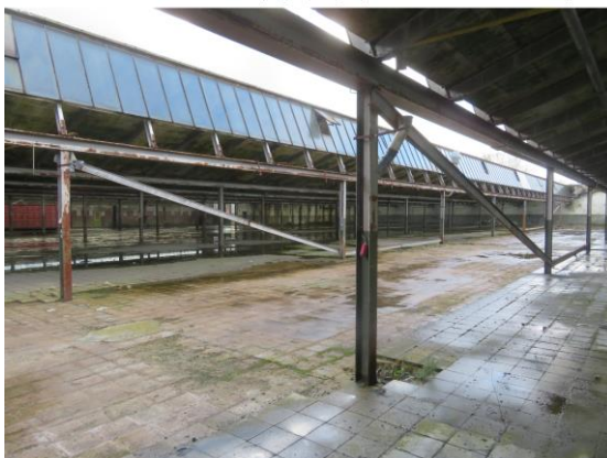
Abb. 4: Innenansicht einer baufälligen Werkshalle mit fehlendem Dach.
