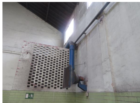
Abb. 27: Schmelzspuren an einem Rohr
