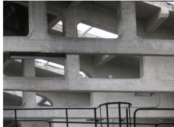
Abb. 23: Nördliche höhere Halle mit Straßentauben in der Dachkonstruktion
